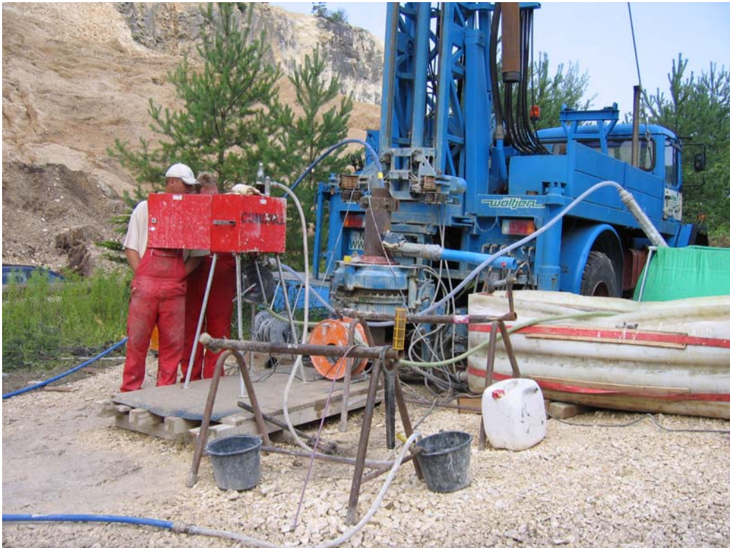
Abb.8 WD-Messbetrieb mit Kreiselpumpe, Zuleitungen und Bohrlocheinbau
