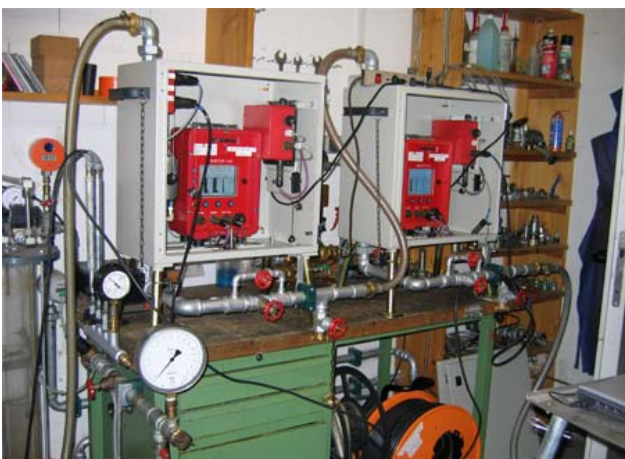
Druck-/Mengenmessgeräte Injektlim/Lugeonlim 4G im Dauertest
